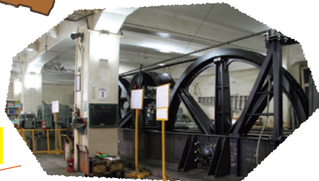
六甲ケーブル バックヤードツアー「巻上場見学」
